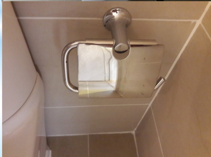
SAI : Lắp thiết bị sai vị trí
