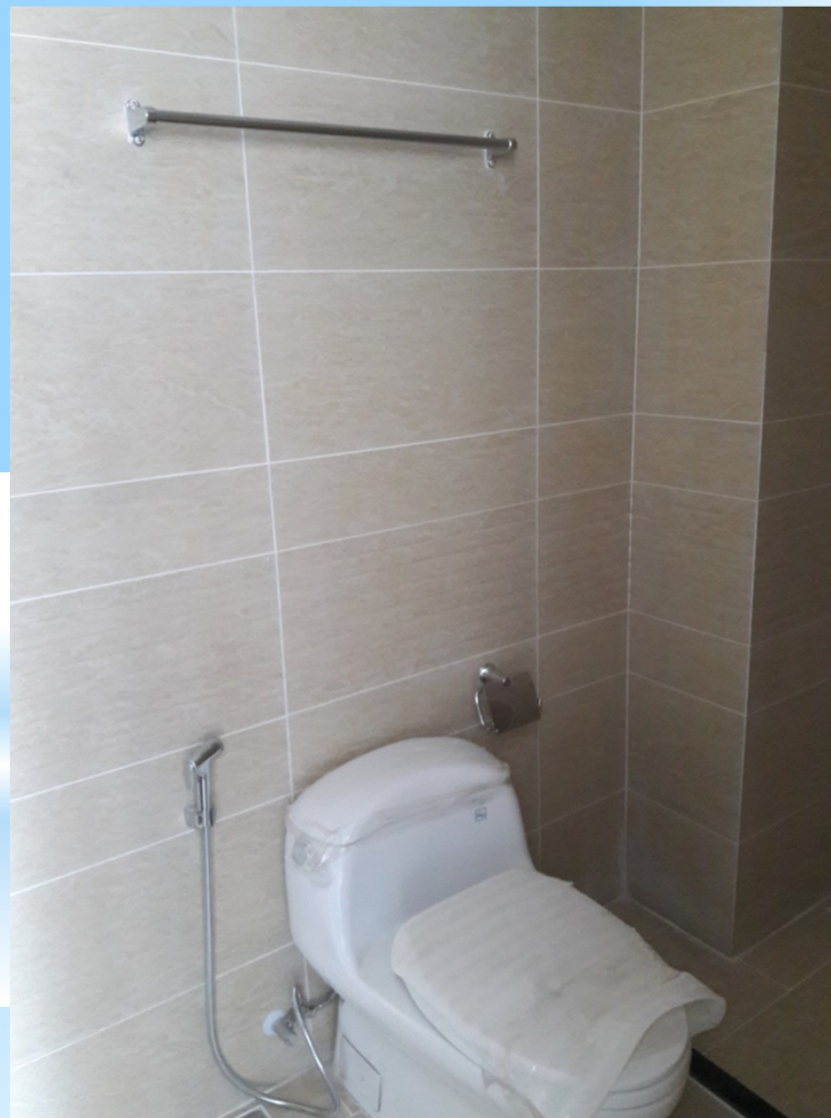
SAI : Lắp thiết bị sai vị trí
